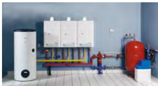
Котельная с тремя котлами DUO 50 FT
