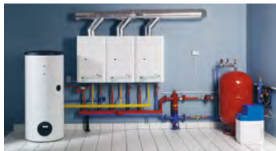
Котельная с тремя котлами DUO 50
