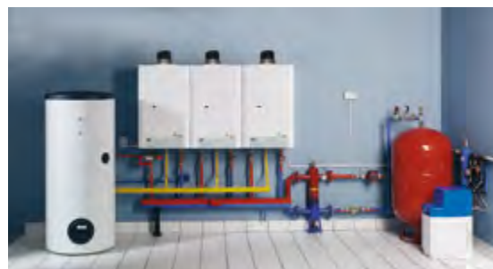
Котельная с тремя котлами DUO 50 T
