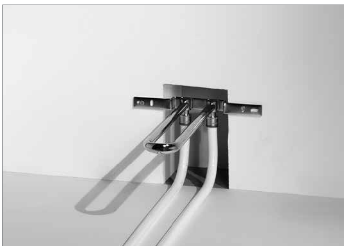
Подключение радиатора с использованием монтажного комплекта — готово для проведения испытания давлением
