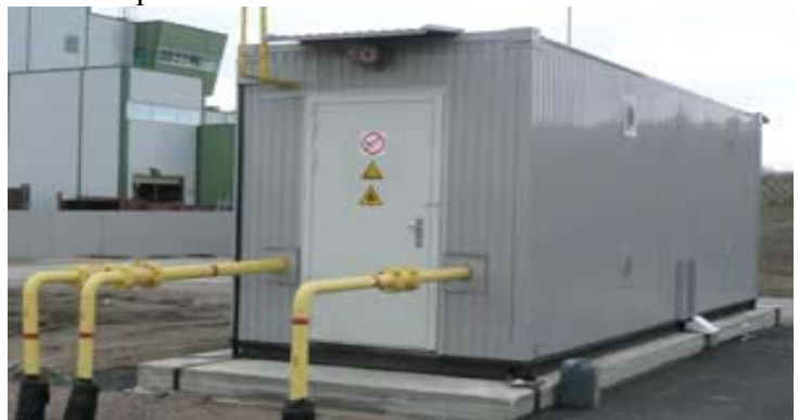
Рис 3.3. - Пункт газорегуляторный блочный
